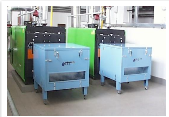
Pojízdňý akustický kryt plynového hořáku.
